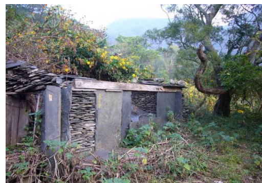
B 牆體及正立面石板仍完整，僅屋頂毀壞者
